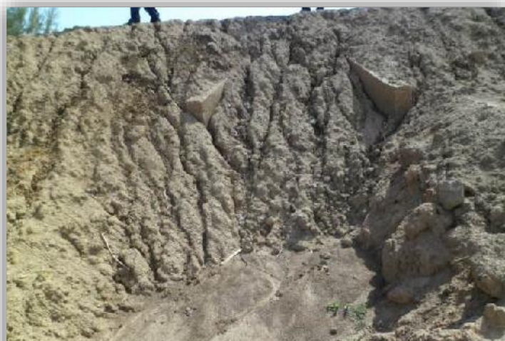
Photo 2: Canal de Begué Palam complètement bouché
