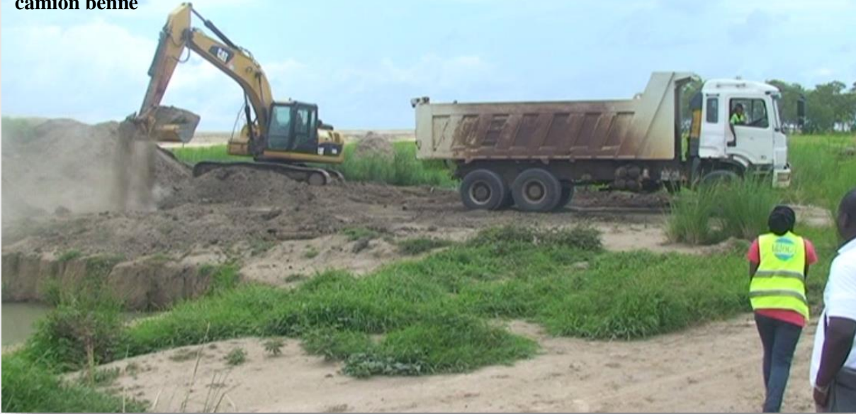
Photo 6 : Versement des tas de terre végétale sur la crête de la digue par le camion benne
