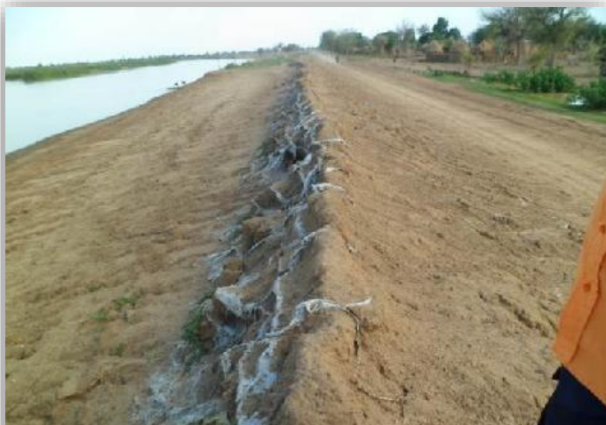
Photo 1: Digue rehaussée par les sacs de terre déjà dégradés au niveau de Doréissou
